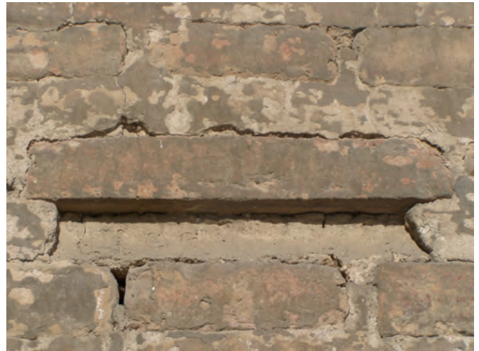
Fig. 8. Detalle de fábricas con juntas selladas, alzados de la Capilla de la Comunión de la Iglesia de los Santos Juanes, Valencia. Los ladrillos empleados son bastante gruesos y anaranjados; su aparejo presenta gruesos tendeles que se remarcan con un sellado y finas llagas que propician una marcada horizontalidad del aparejo (CRISTINI)
